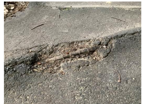
竹の根によるアスファルトの亀裂
